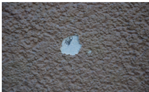
Zdjęcie nr 1. Przykładowe, punktowe i powierzchniowe uszkodzenie mechaniczne zewnętrznych warstw systemu.
