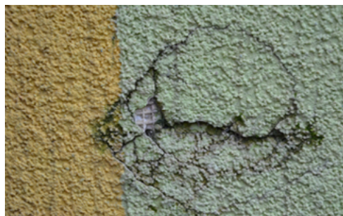
Zdjęcie nr 2. Przykładowe, punktowe uszkodzenie mechaniczne zewnętrznych warstw systemu z naruszeniem warstwy zbrojonej. Brak wykonania szybkiej naprawy spowodował dodatkowo pojawienie się porażenia mikroorganizmami.
